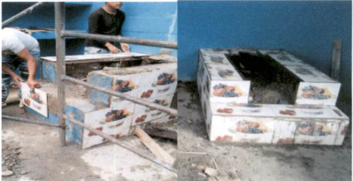
Foto 6: Mantenimiento a estufa rural
